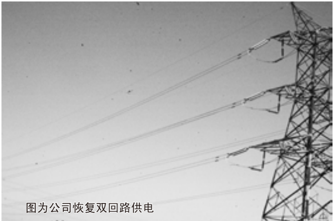
图为公司恢复双回路供电
