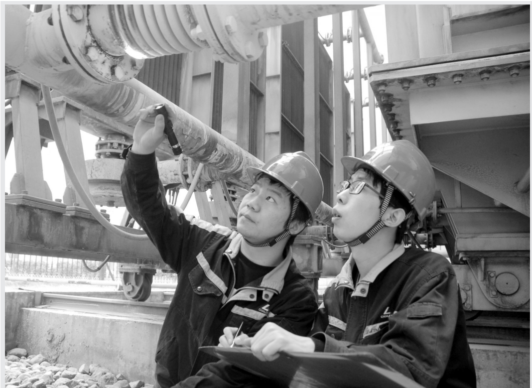
▲近日,山西新材料动力厂供电车间组织专业技术人员对220千伏整流系统设备缺陷进行攻关,改善设备条件,确保整流系统长期安全稳定运行,为电解系列提供平稳恒定电源。图为技术人员正在排查一系列调压整流变压器缺陷。姜涛 摄影报道
