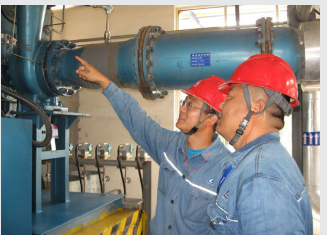
▲9月份,中铝山东有限公司动力厂煤气站空班积极开展“学技术、提技能、保运行”活动。班组成员在党员骨干的带动下,精心操作,认真巡检,严格检测设备运行状态,及时调整各运行参数,确保设备长周期高效运行。图为班组成员正在设备旁交流如何正确操作调试膨胀机油压。李军 赵长海 摄影报道
