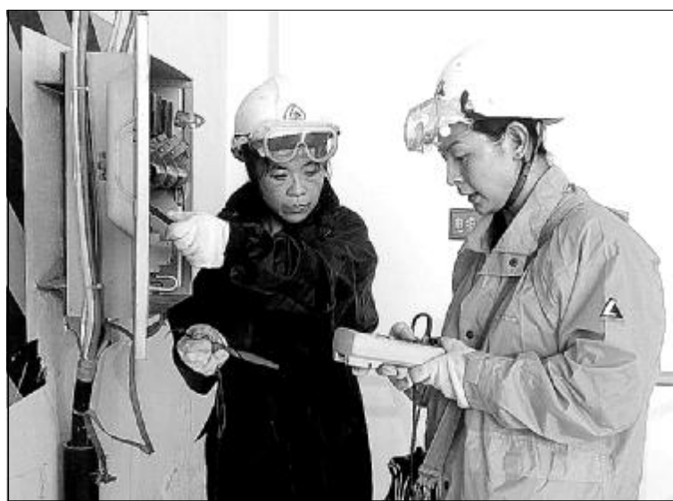
在雨季来临之前,第二氧化铝厂蒸发车间成立了防汛小组,防汛突击队队员日常对车间所属各变配电室、油库、地坑等防汛重点部位进行实时监控、巡逻。各班组按照该车间防汛演练作业标准,依次展开演练。旨在暴雨袭击时,快速高效进入抢险状态。图为该车间电工班员工正在连接雨排水泵电源线路。 兰岗 摄
